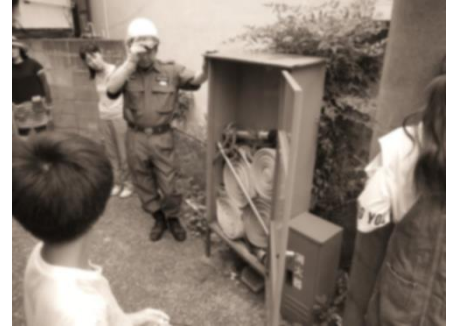
初期消火箱(ホース1本20メートル)
